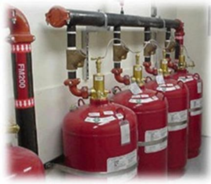
Resim 1.14: FM200 söndürme sistemi
