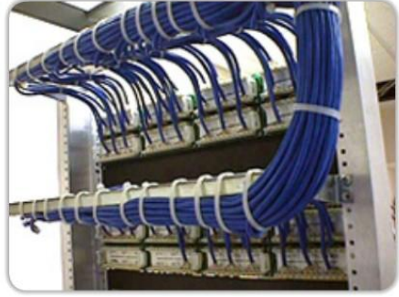
Bağlantı Panosunun Arka Tarafı
